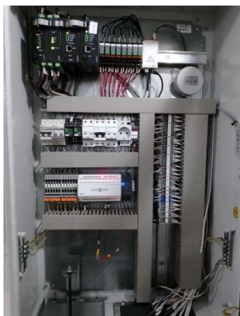
АВР на ПЛК Макон в отдельном шкафу
