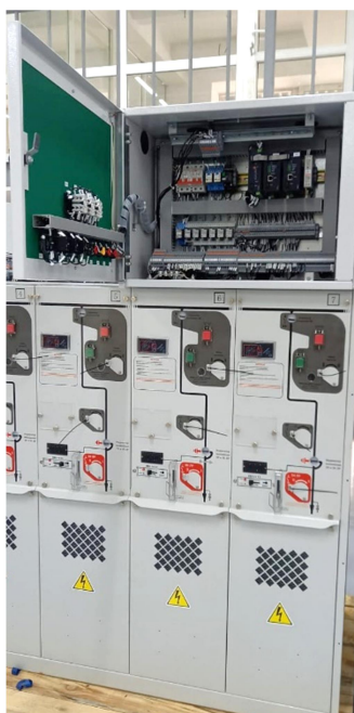
АВР с ВНР на ПЛК Макон в низковольтном отсеке РУСН
